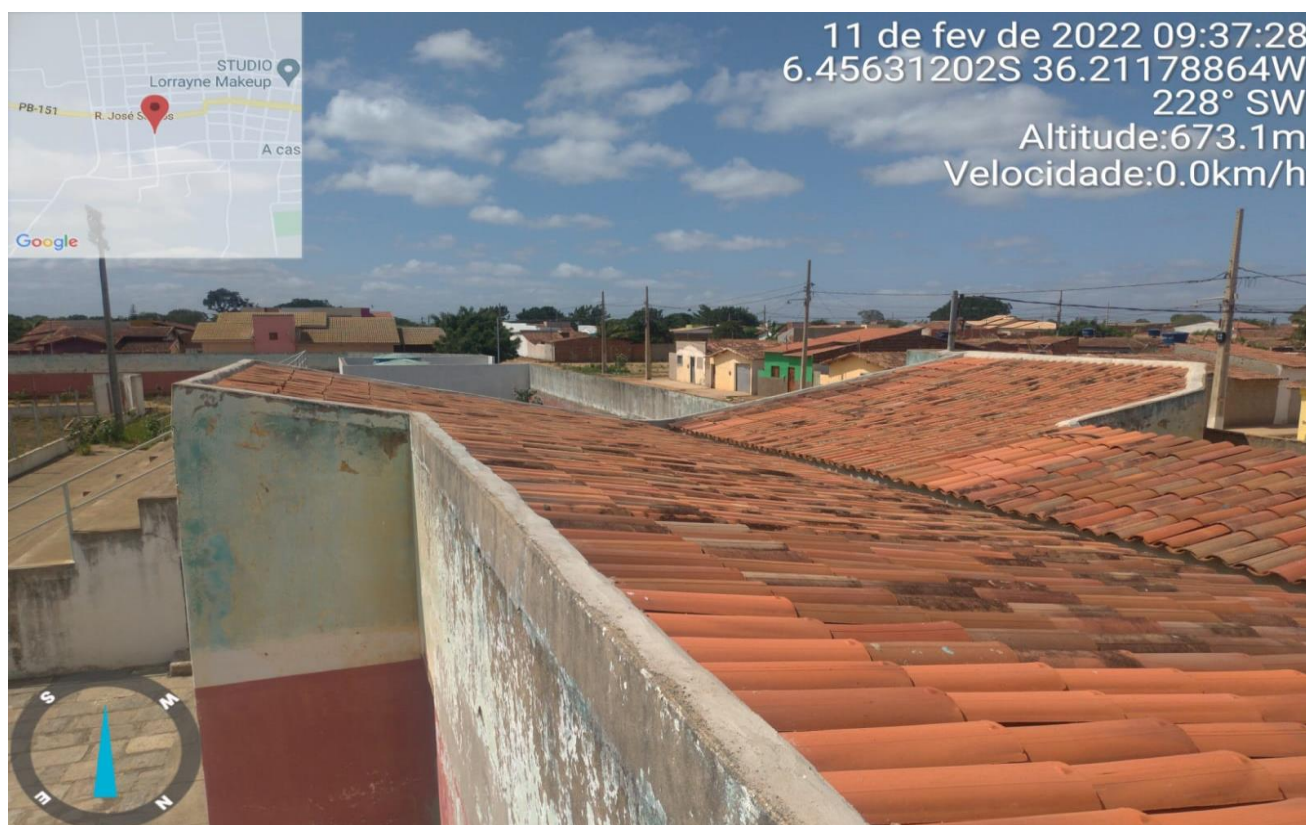
Figura 4: Todo o telhado será substituído
