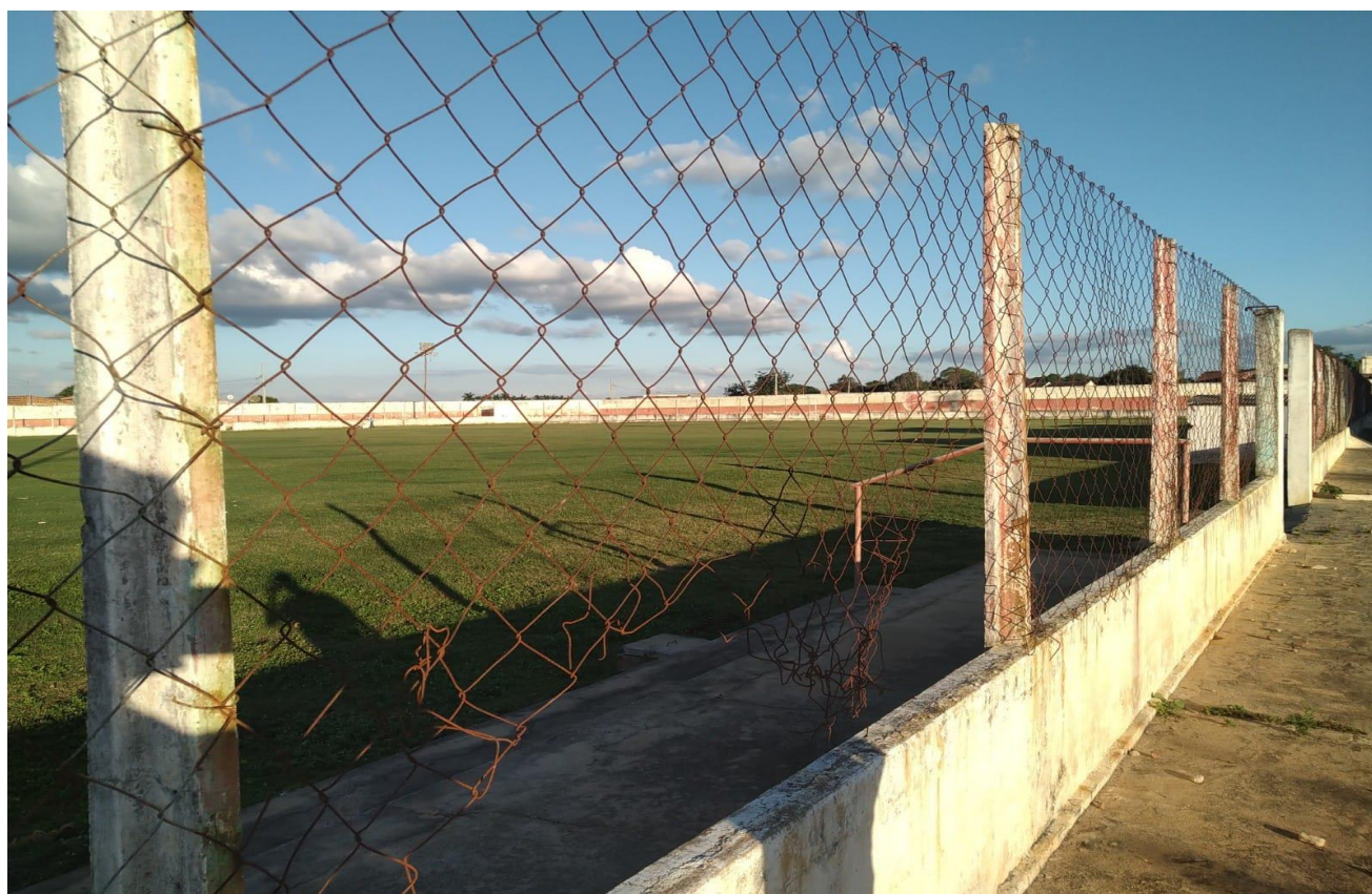
Figura 11: Telas do alambrado a serem substituídas
