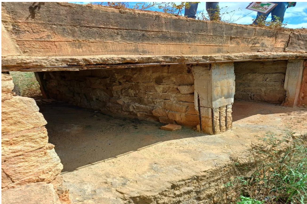
Figura 4: Pilares danificados e ausência de pedras em alguns pontos
