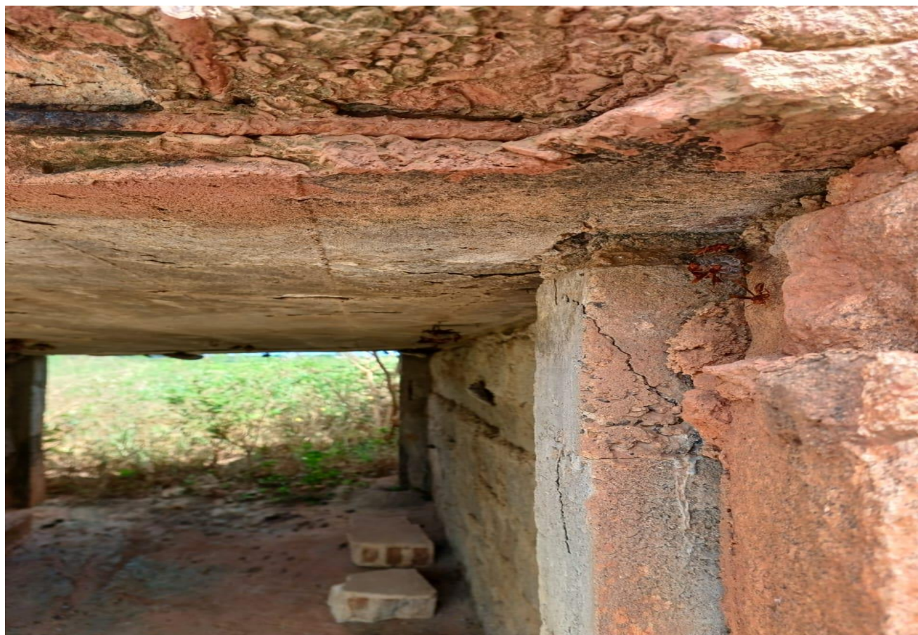
Figura 5: Pilares e lajes danificadas
