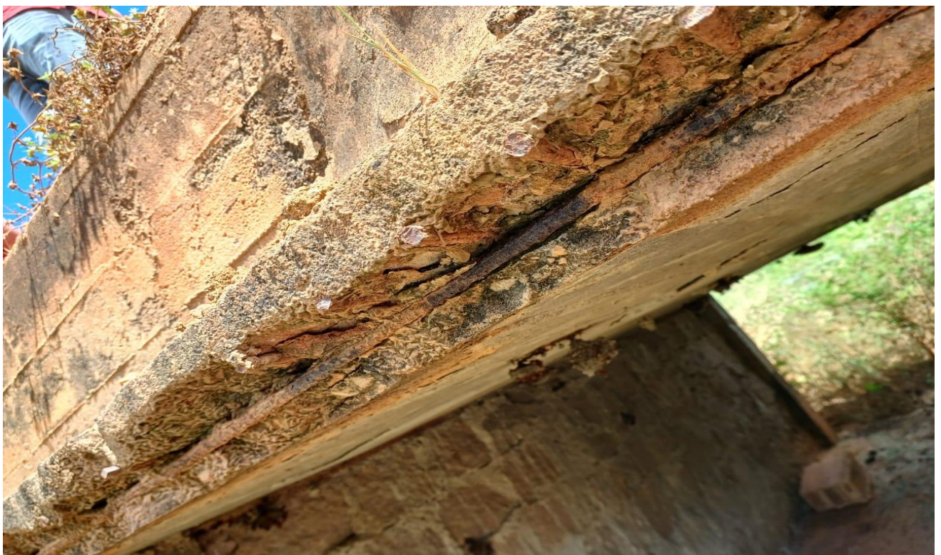
Figura 3: Armadura exposta - sem cobrimento
