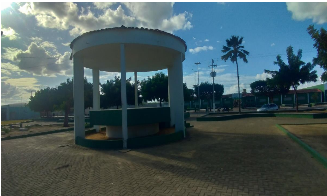
Figura 3: Coreto da Praça - será instalado guarda-corpo
